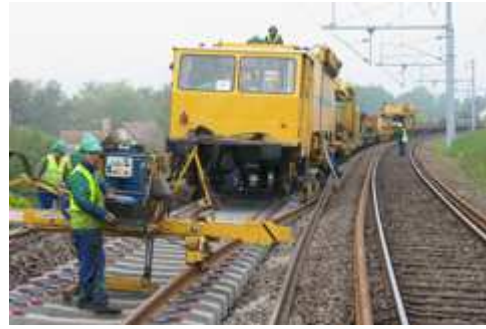
Longs Rails soudés sur traverses béton
